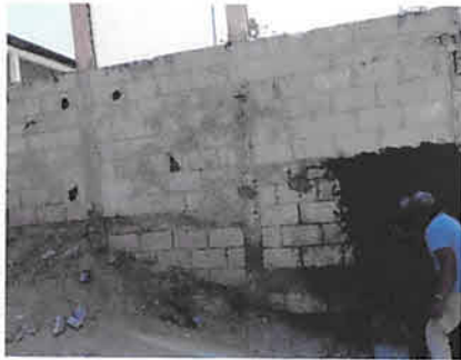
Foto1: Reparación de muro perimetral, area de patio 1 y 2 en colocacion de cernido con sabieta y cambio de malla
